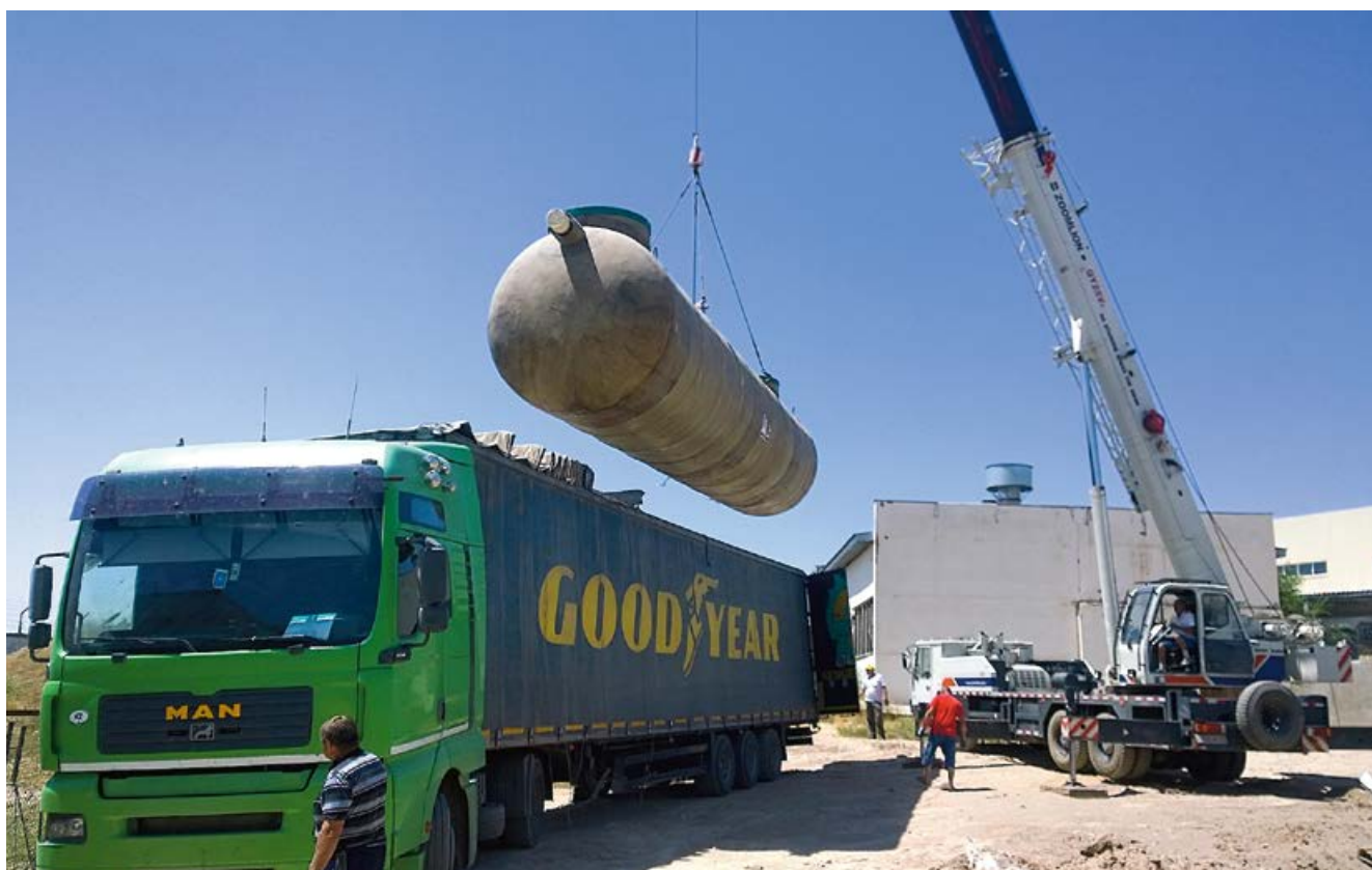
ЛОС-ЕМ хранения противопожарного запаса воды объемом 60 м 3 . Ленинградская область. 2014 г.
