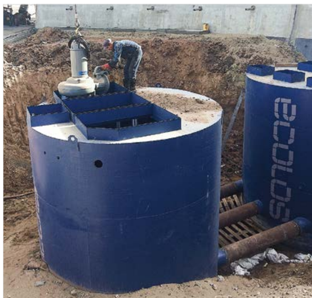
Станция КНС производительностью 350 м 3 /ч г. Самара. Реконструкция Московского шоссе. 2016 г.
