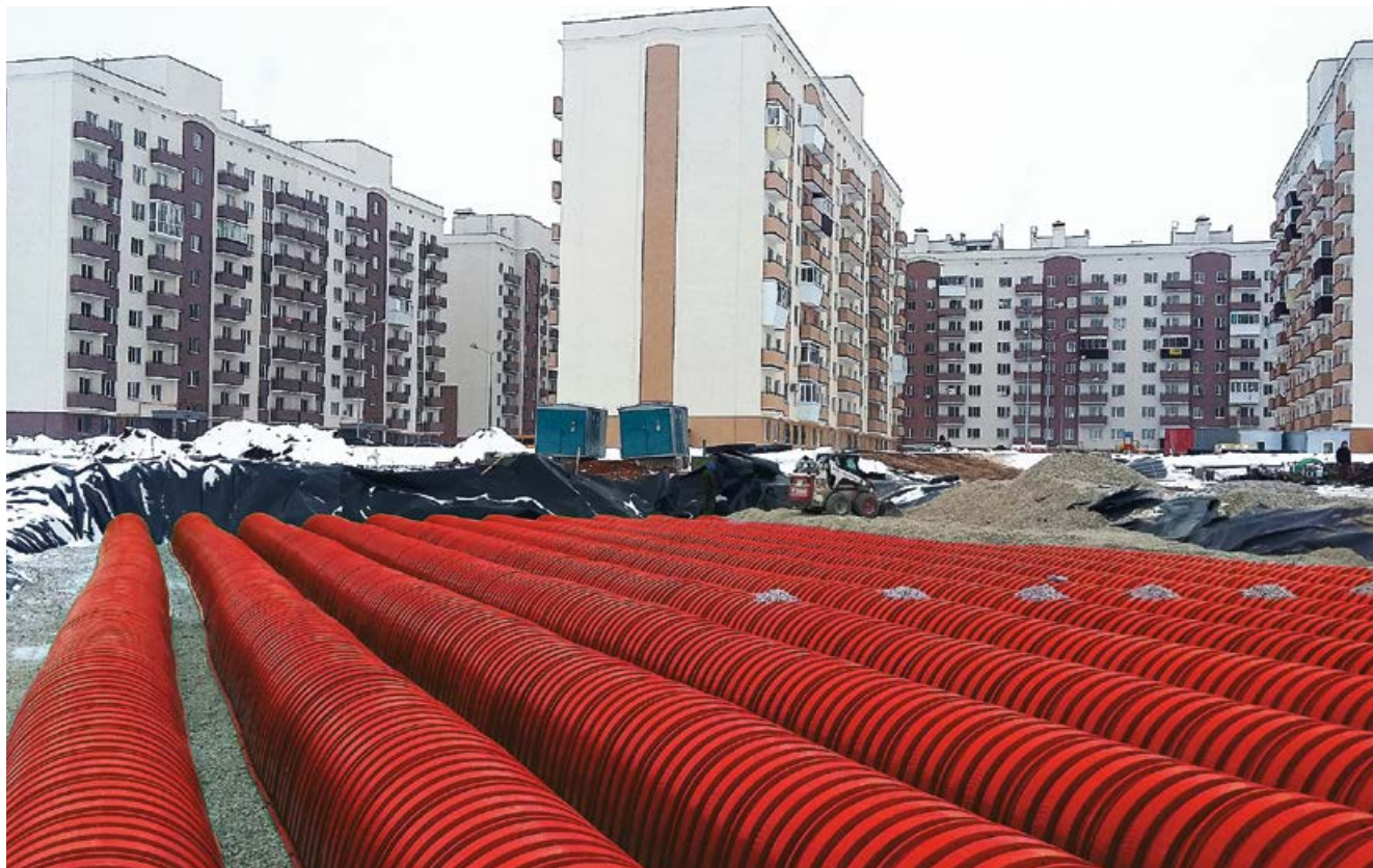
Система регулирования сточных вод производительностью 100 л/с. Самарская область, г. Самара, мкр. Южный Город. 2015 г.
