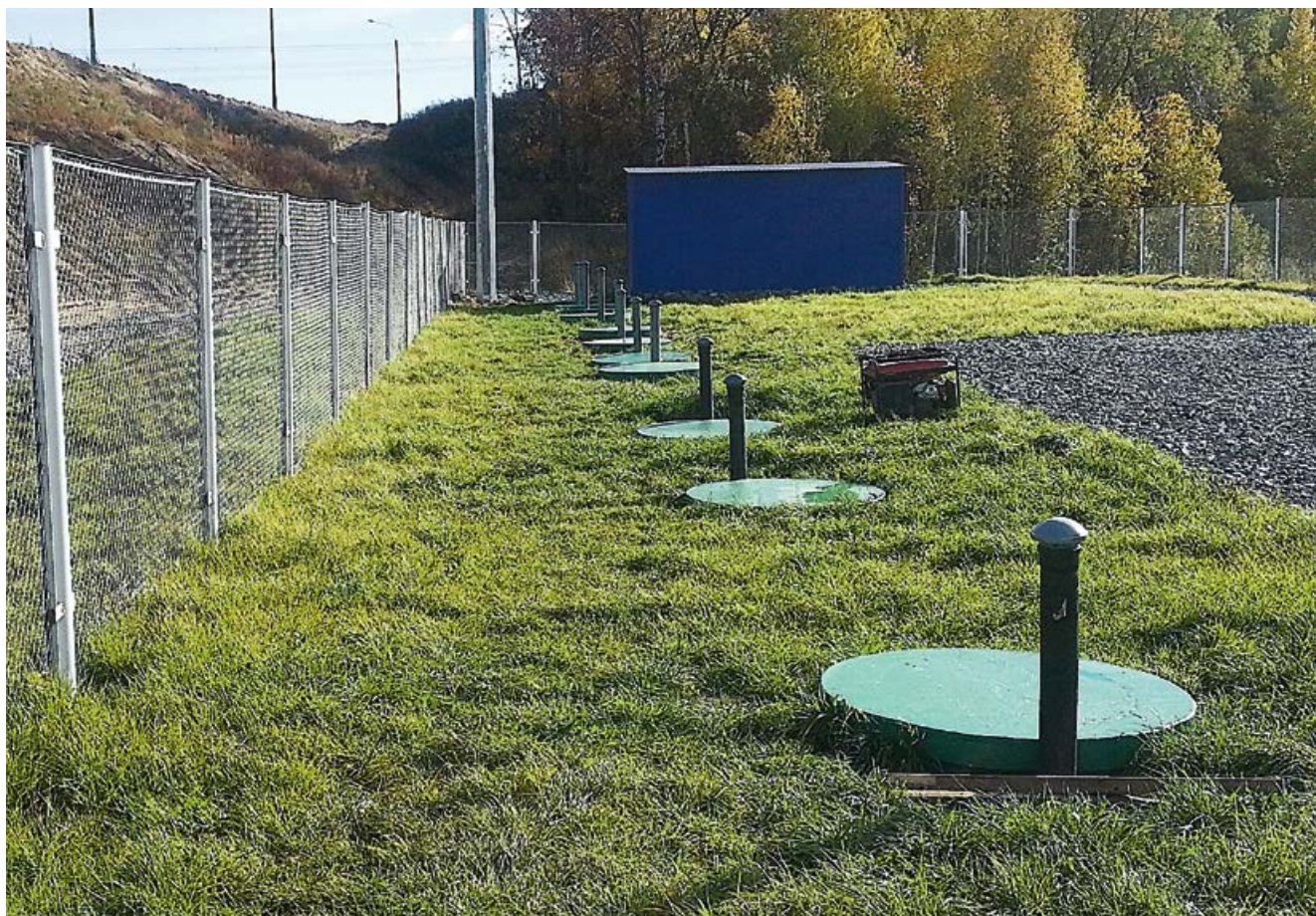
Пескоуловитель ЛОС-П в системе ливневой канализации. Производительность системы 100 л/с. г. Алмаата, респ. Казахстан. 2016 г.
