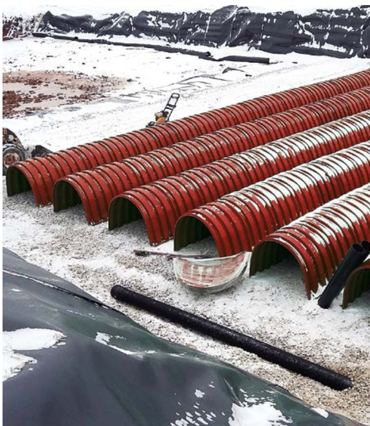
Система регулирования сточных вод объемом 1710 м³. Реконструкция Московского шоссе, г. Самара. 2017 г.
