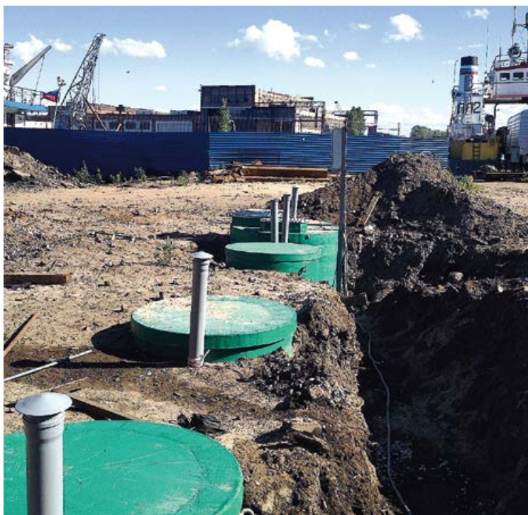
Пескоуловитель ЛОС-П в системе ливневой канализации. Производительность системы 120 л/с. г. Балтийск. 2014 г.
