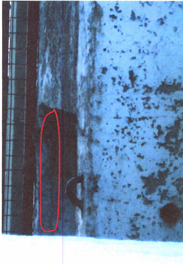
Фото 1. Разрушение защитного слоя с оголением арматуры , трещина вдоль арматуры на отметке 1м колонны в осях А/1.
