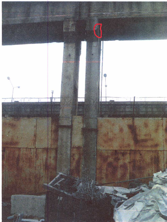
Фото 6. Трещины вдоль арматуры колонны в осях Б/14, оголение арматуры.
