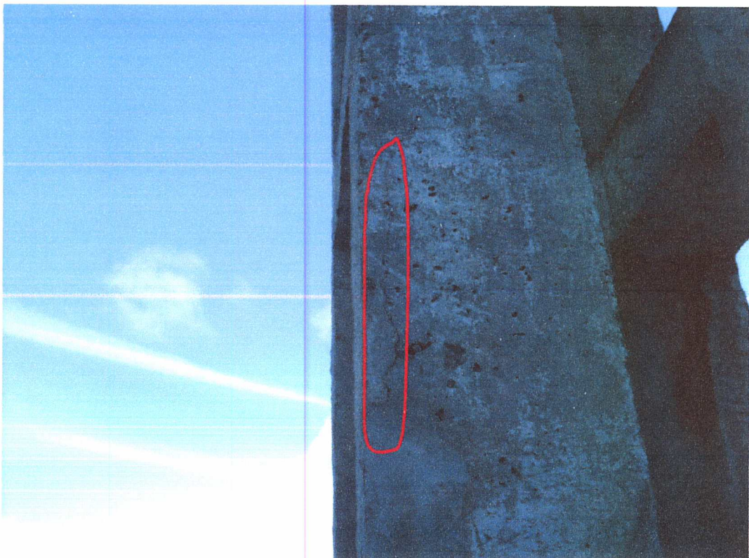
Фото 2. Трещины вдоль арматуры обеих колонн в осях А/18
