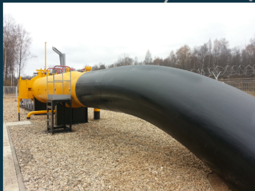
Камера запуска-приема газопровода. ПАО "Газпром" Торжокское ЛПУМГ "Форпол-Ойл"
